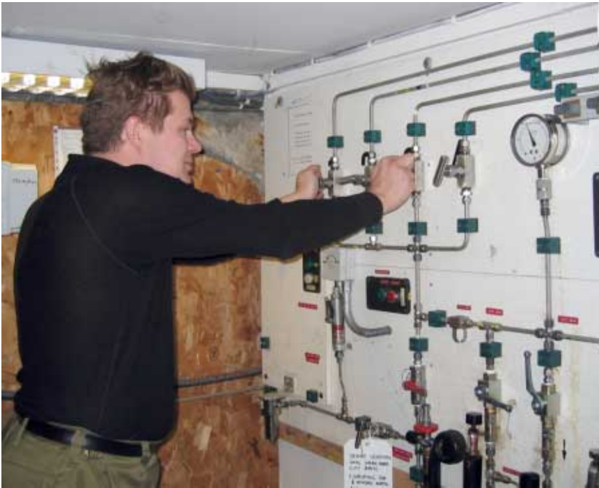
Marko operoimassa täyttöasemaa. Kuva Pekka Vaittinen.
